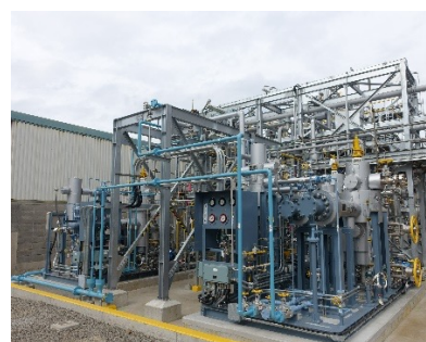
CO2からメタノールを製造するパイロット設備
