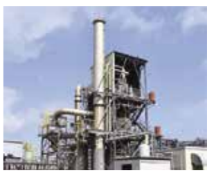
排液燃焼設備 役割 | 排水焼却
