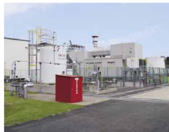
非常用発電機
