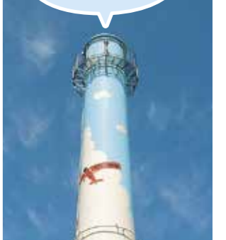
ボイラー・ガスタービン共用煙突
