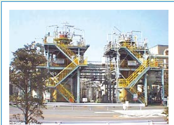
高濃度廃水焼却設備
