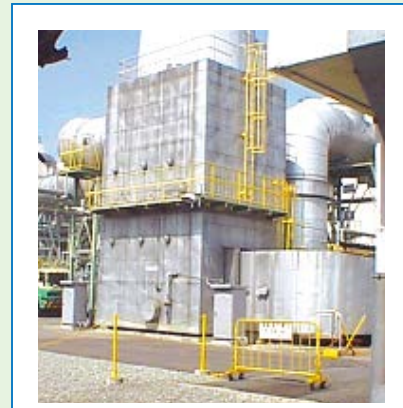
排煙脱硝設備
